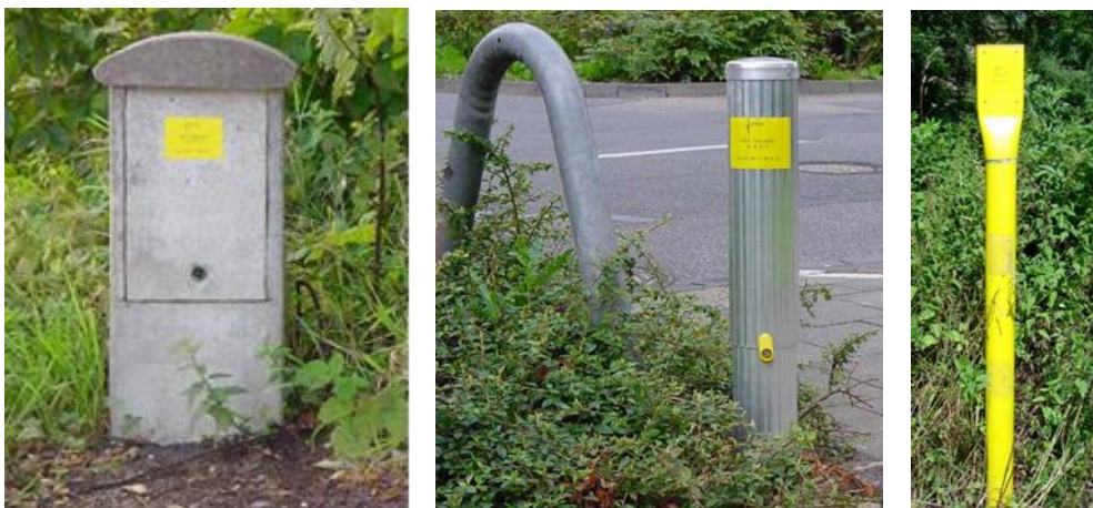
Abbildung 8 Messstellen für kathodischen Korrosionsschutz
