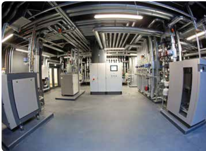
Energiezentrale im NEW-Blauhaus
