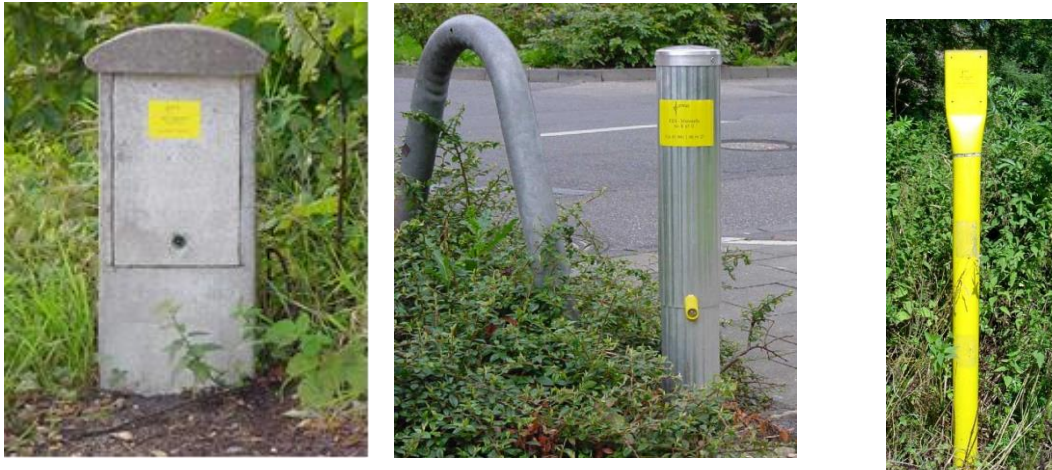
Abbildung 8 Messstellen für kathodischen Korrosionsschutz
